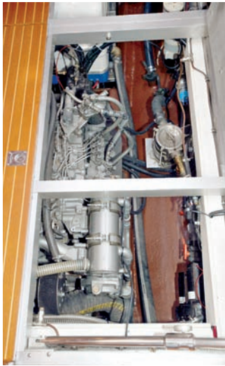
Blue Magicissa on Yanmar-diesel, joka on asennettu hyvin äänieristettyyn tilaan salongin turkin alle. Pääkoneen edessä on hiljainen aggregaatti.
