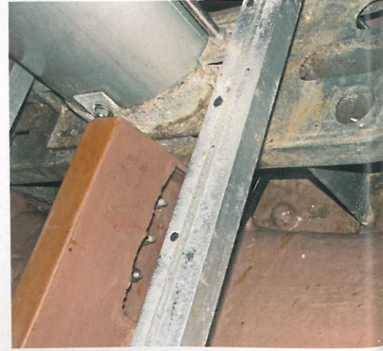
Ein unschönes Detail - die Mastfußkonstruktion aus verzinktem Stahl neigt zu Korrosion
